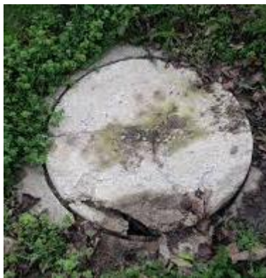
Tampon de fosse fissuré
