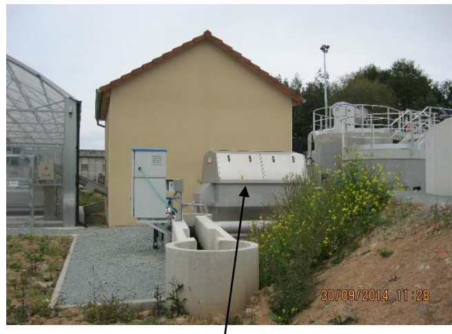
Filtration de la station d'Anjoutey
