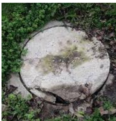
Tampon de fosse fissuré
