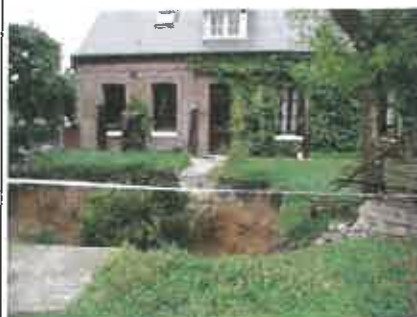
Conséquence d'un affaissement (Somme) – (Source : BRGM)
