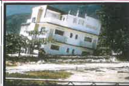
Liquéfaction des sols suite au séisme de Caracas (Vénézuéla) en 1967 (Source USGS)
