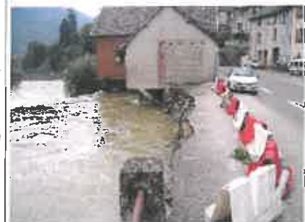
Érosion de berges à Lods (25) - 2006 (Source DLA)
